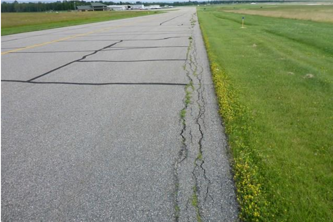
GPZ PTA 003 (PCI = 55)
