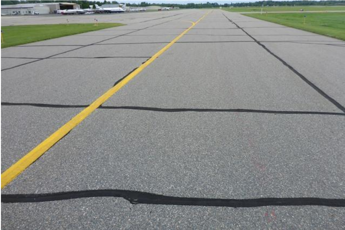
GPZ PTA 001 (PCI = 73)
