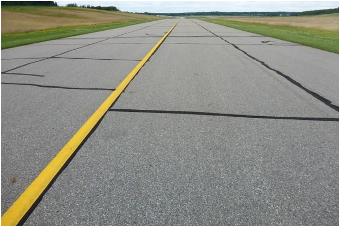
GPZ PTA 004 (PCI = 70)
