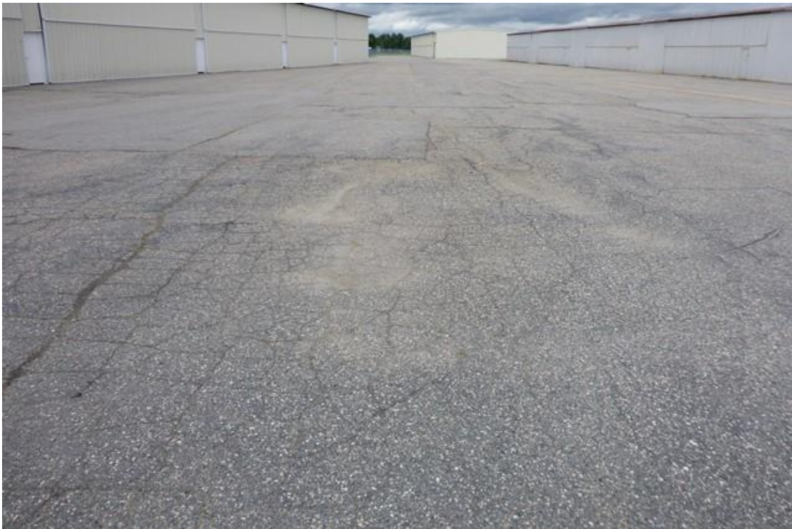
GPZ TLE 001 (PCI = 24)
