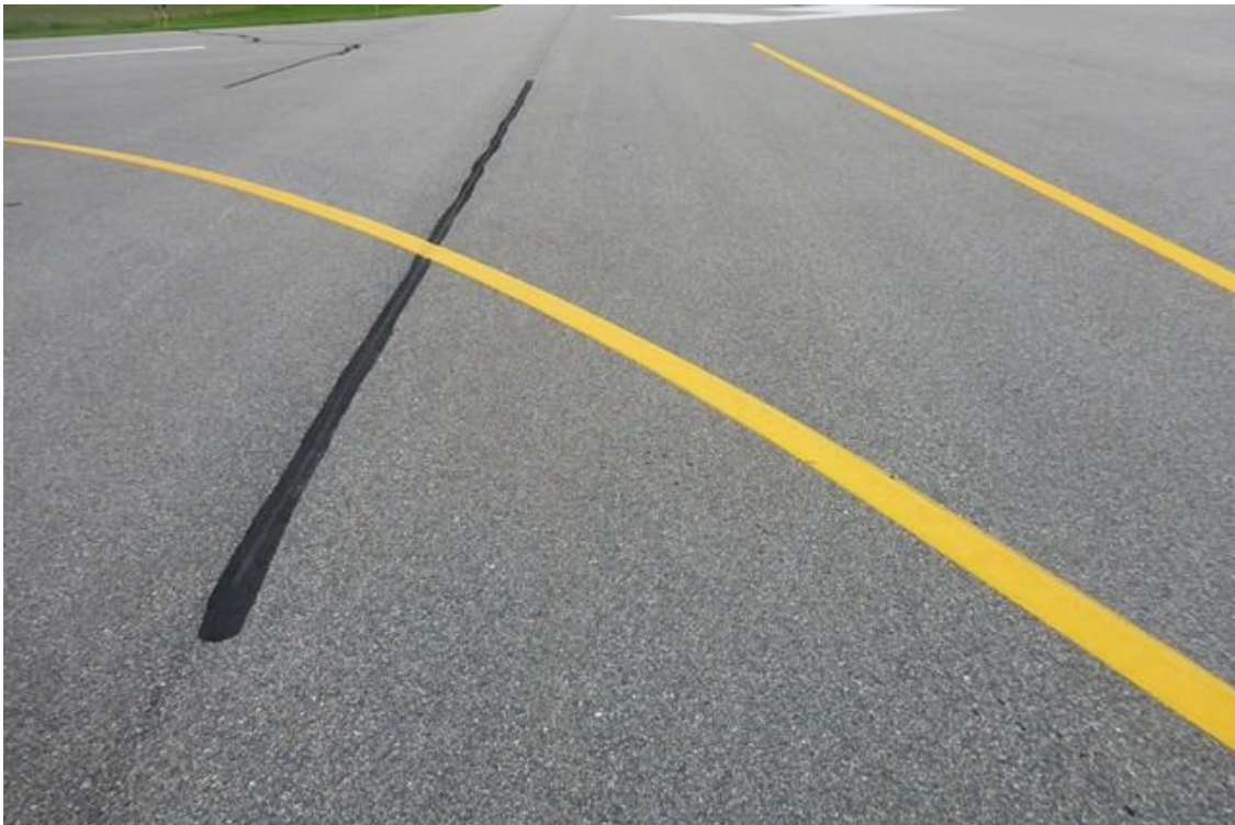
GPZ PTA 002 (PCI = 95)
